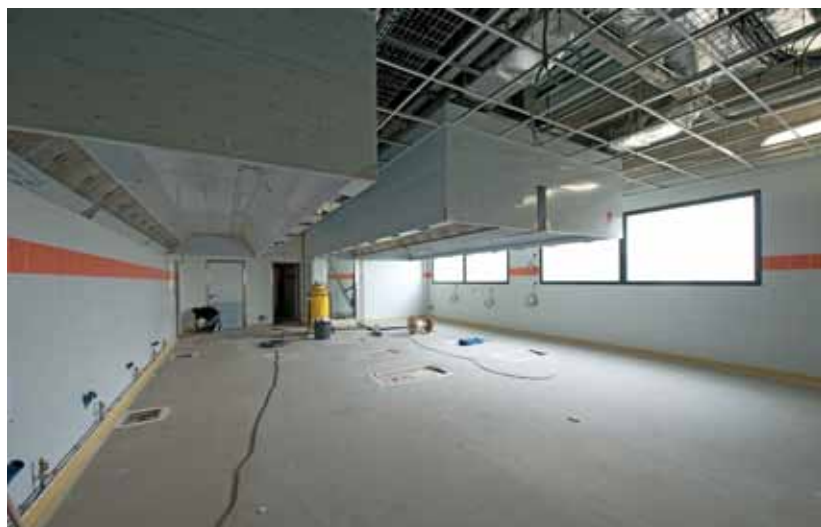
Ici, la future salle de cuisson de la cuisine centrale avec deux grandes hottes.
