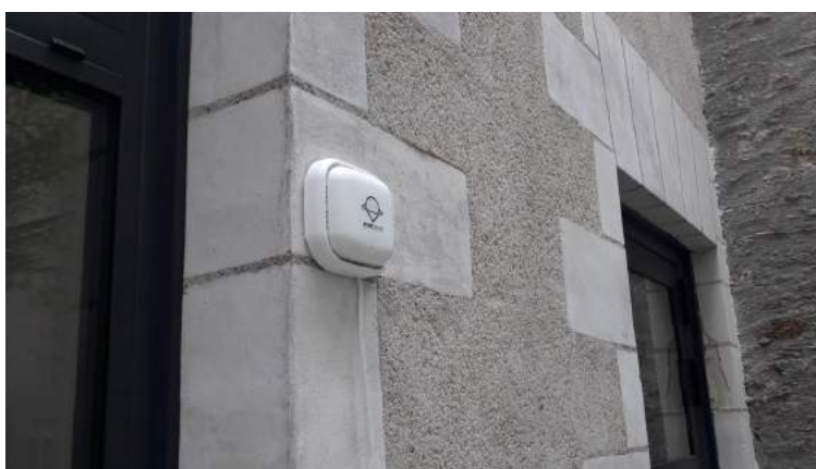
Figure 9 : Capteur AtmoTrack installé en extérieur
